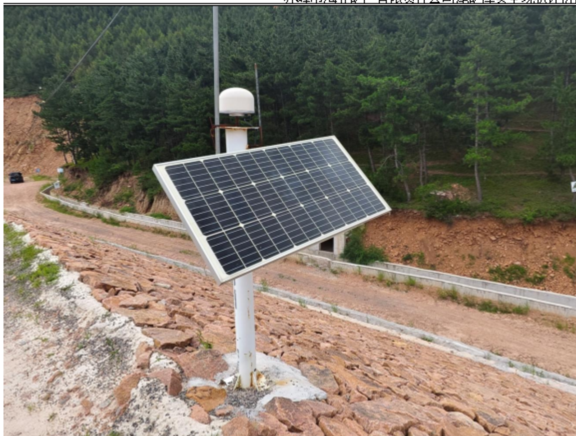
在线位移监测设施
